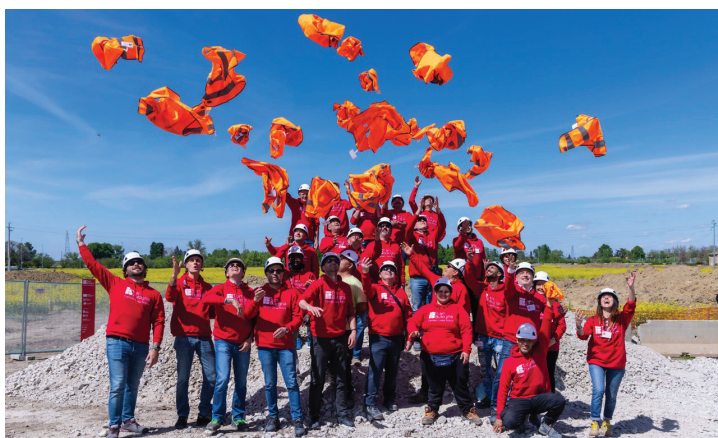
L'AVVIO DEI LAVORI PER LA REALIZZAZIONE DELLA LINEA ROSSA DEL TRAM DI BOLOGNA, A BORGO PANIGALE. HOMINA STA CURANDO LA COMUNICAZIONE DI CANTIERE.
